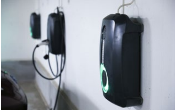
Föreningen installerade åtta laddplatser för elbilar i sitt garage
