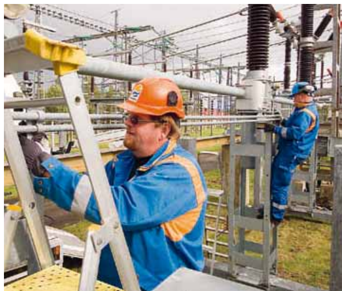
Brytarbyte vid en av Svenska Kraftnäts anläggningar.
