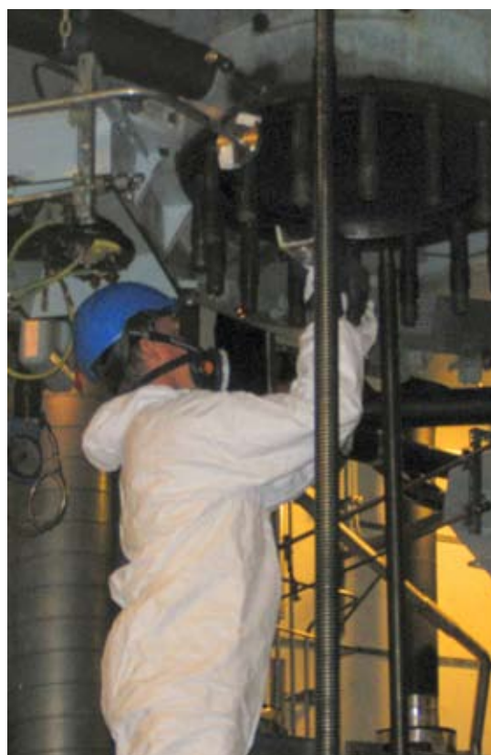
Underhållsarbete på en huvudcirkulationspump.
