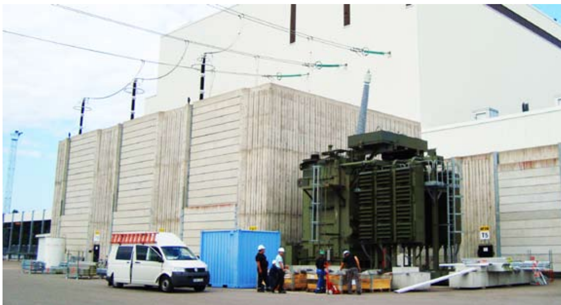
Bakom Forsmark 3 byggdes arbetsställningar för att arbete på transformatorerna skulle kunna utföras.
