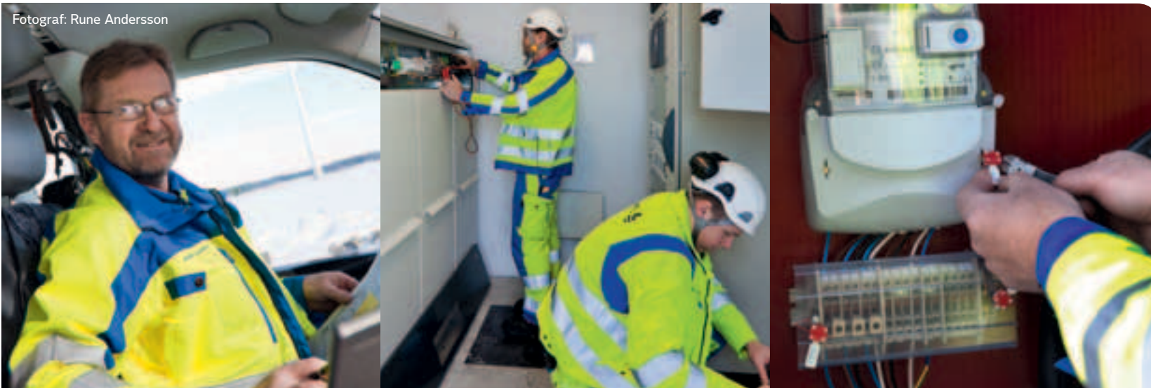
Anders Lundquist och Johan Möttönen gör mätningar på ett vindkraftverk.
