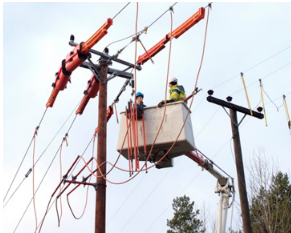
AMS-bilens lift är isolerad för att klara spänningar upp till 138 kV.
